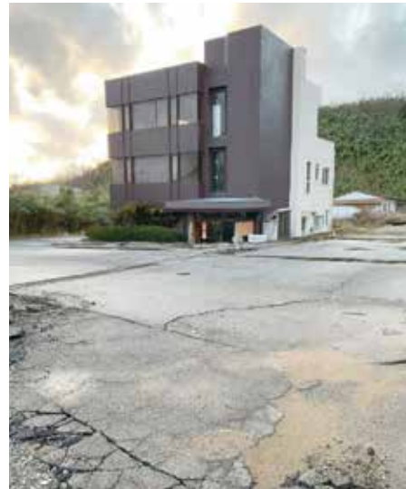
写真2 地盤の液状化により地面にめり込んだ低層ビル（内灘町西荒屋）。
